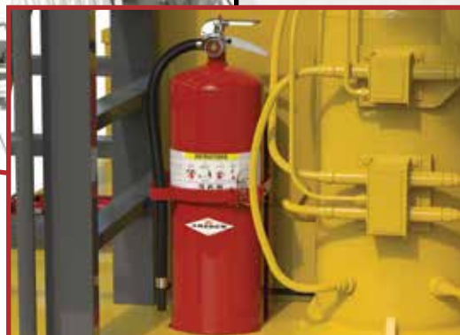
Extintor de Alto Fluxo
