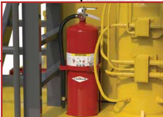
Extintor de Alto Fluxo
