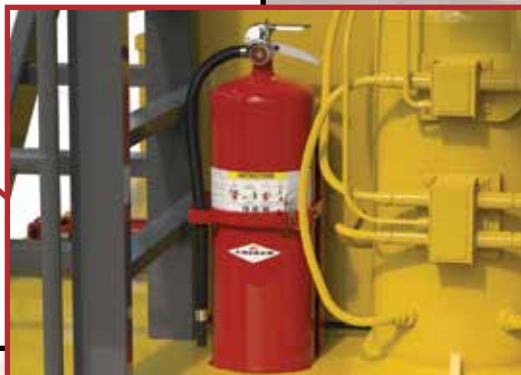
Extintor de Alto Flujo
