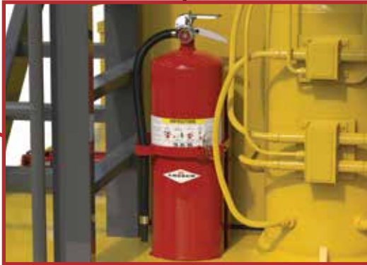
Extintor de Alto Flujo
