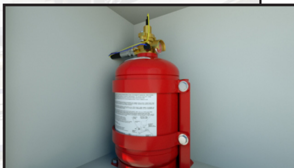
Cilindro de Agente Extintor
